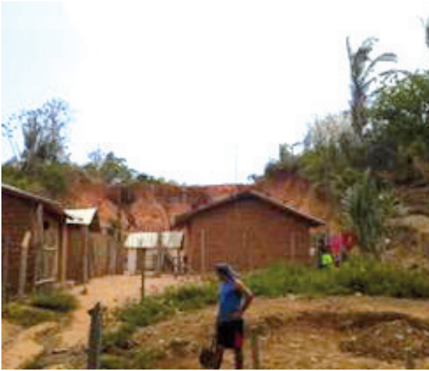
Foto 38: Fenômeno de erosão acelerada sobre rebordo erosivo dos tabuleiros cimeiros, em área de risco geológico devido à ocupação urbana desordenada
